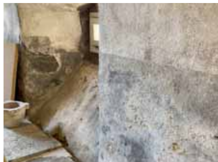
Bild 13: Kelleraussenwand mit typischen Schäden durch Salzausblühungen.
