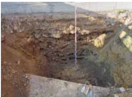
Bild 2: Stark zerklüftetes und unregelmässiges Natursteinmauerwerk im Untergeschoss ohne Abdichtung.
