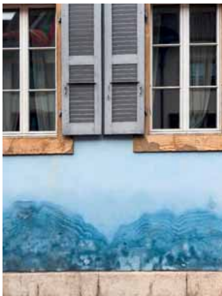
Bild 6: Der Steinsockel passt, aber zur Fassade stimmt die Bautechnik nicht. Hier kann auch eine Silikatfarbe das Problem nicht lösen.
