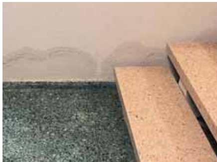
Bild 8: Durch eine undichte Betonfuge in der Bodenplatte ist Niederschlagswasser eingedrungen.
