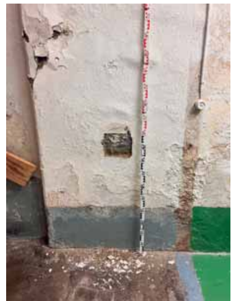
Bild 10: Alles Mögliche wurde ausprobiert an einer feuchte- und salzgeschädigten Kellerwand.
