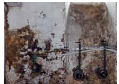
Bild 14: Kelleraussenwand mit starken Feuchtigkeits- und Salzschaubildungen.
