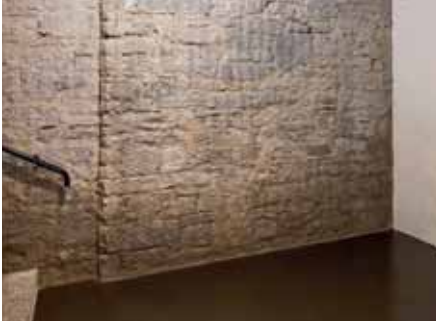
Bild 11: Freigelegtes Natursteinmauerwerk ermöglicht raschere Austrocknung in den Raum.
