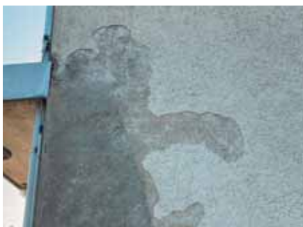
Bild 9: Grossflächige Putzabplatzungen durch mangelhaft ausgeführtes Anschlus- sdetail.
