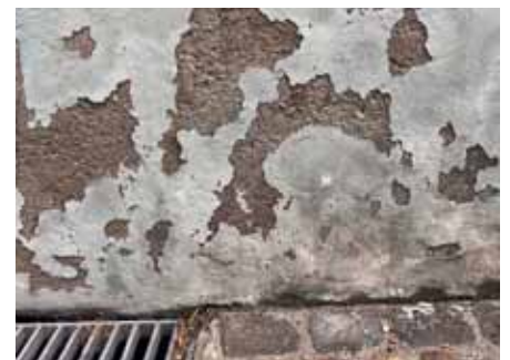
Bild 5: Typischer Spritzwasserbereich an einem Altbau. Es sind zahlreiche Spuren verborgener Sanierungsversuche erkennbar.
