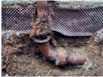
Bild 3: Die Verbindung eines Ablaufrohres hat sich gelöst und das Wasser durchfeuchtet die Kelleraussenwand.
