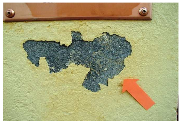
Zu dicker Farbauftrag führte zu Abplatzungen
