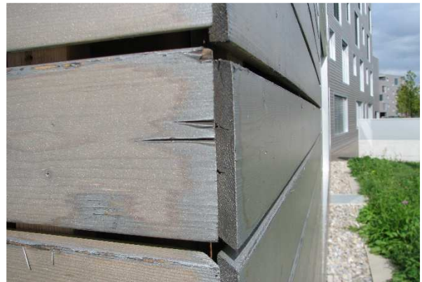
Konstruktionsbedingte Schäden an einer Holzlasur
