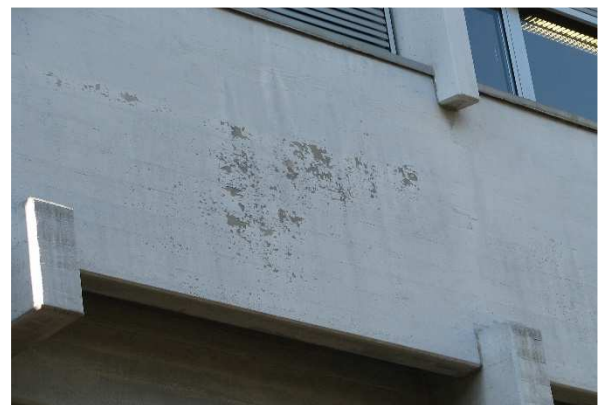
Anstrichschaden an einer Stahlbeton Fassade
