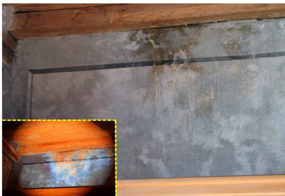
Das ganze Ausmass von Wasserflecken wird sichtbar
