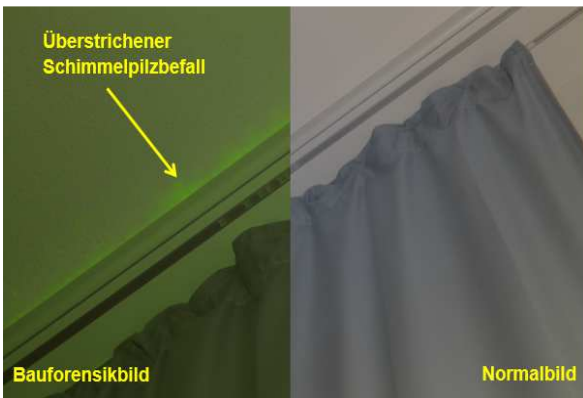
An der Vorhangschiene in einem Schlafzimmer überstrichener Schimmelpilzbefall
